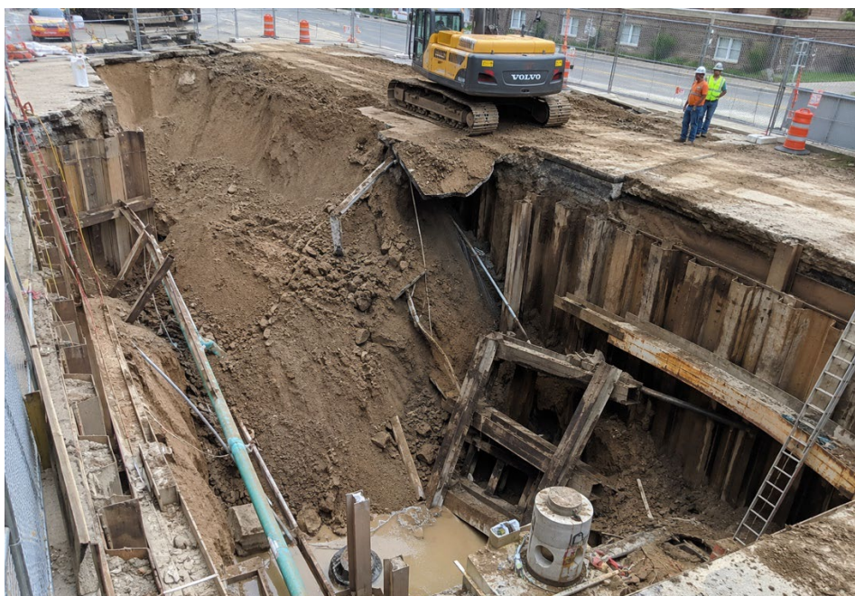
Фиг. 2. Реален аварийен случай при срутване на строителен изкоп вследствие на недостатъчно укрепване и повишено повърхностно натоварване
