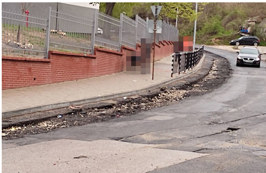
Фиг. 1. Състояние на пътната настилка след нискобюджетни краткосрочни ремонти (24rodopi.BG, 2022).
